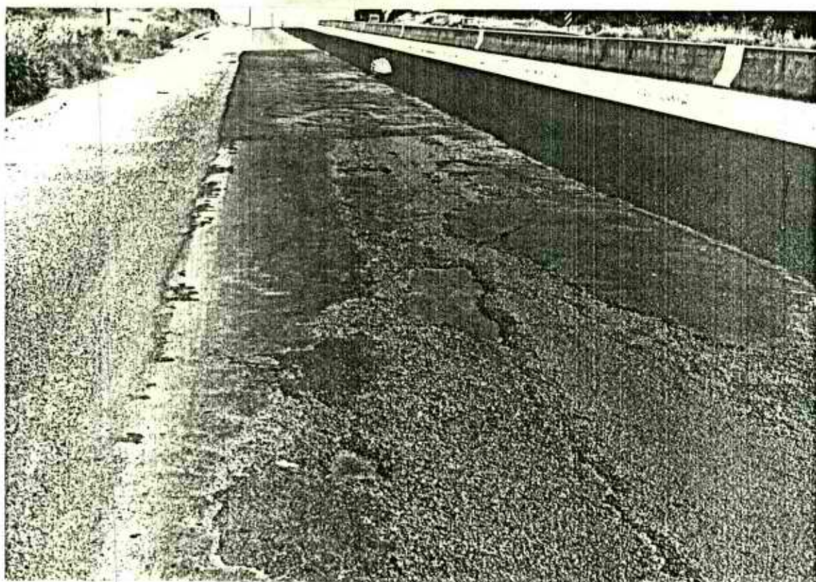
התמונה צולמה בכביש מס' 2 (תיא - חיפה) בקטע געש - אודים במסלול המערבי. הרס השכבה העליונה כתוצאה מבלאי עקב עומס התנועה. הטיפול הנדרש: קירצוף הנתיב וריבודו בשכבה בת 4 ס"מ אספלט.
